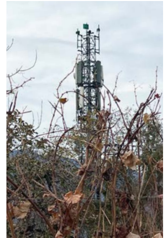
Der Mobilfunkumsetzer „Jansen“ wurde erhöht
